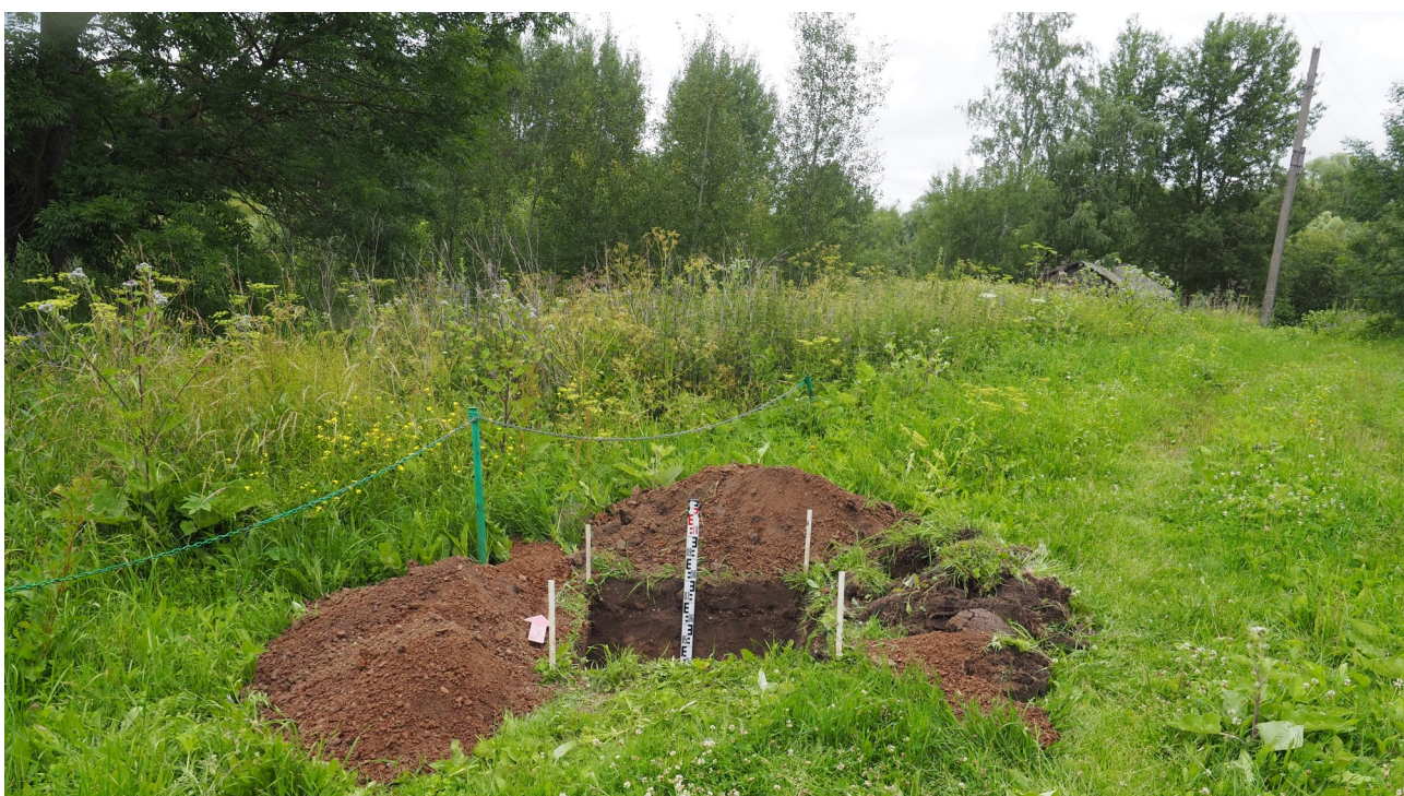
Рис. 31. Калужская область, Мещовский район. 2023 г. Археологическое обследование по объекту: «Уличные газопроводы дер. Тушенка». Вид на раскопанный шурф 1 с юга.
